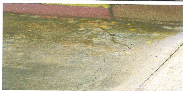
Foto 5: Piso en mal estado en las aulas.
