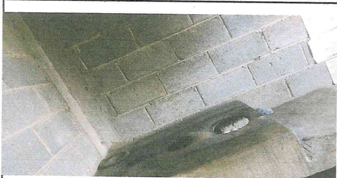
Foto 1: Estufa Rural en mal estado.
