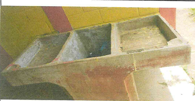
Foto 3: Pila en mal estado.
