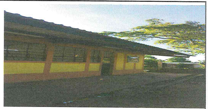
Foto 2: Pintura de escuela deteriorada.
